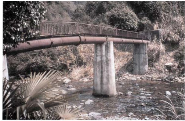
Photographie 5.31 : Canal autoporté
